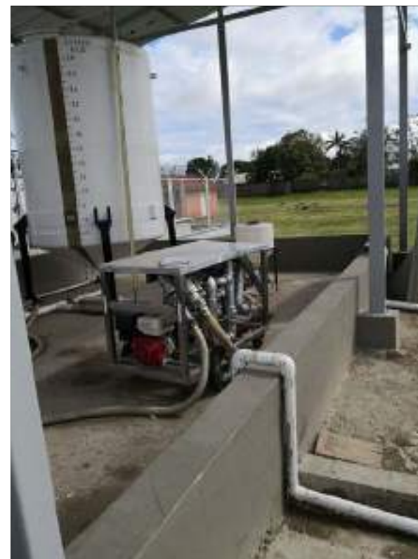
Equipo de bombeo de mezcla de aspersión, con motor a gasolina. San José de Guaviare, Guaviare.
